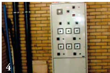
4. viser (i baggrunden) den gamle skylleautomat til filterskylningen i årene 1977 – 1991, hvor programmerne i den nye tavle kunne klare skylningerne mere præcist efter m^3 .
