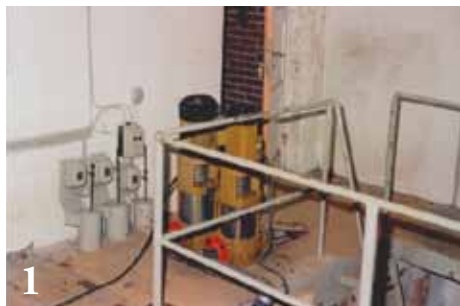
1. viser 3 vippekontakter som styrede boringerne når rentvandsbeholderen var tom.
