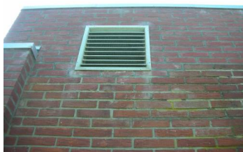
Iltningstårn Udluftning mangler insektnet.
